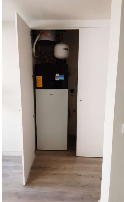
Máquina interior con hidrokit dentro de armario
