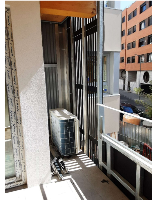
Máquina exterior en terraza
